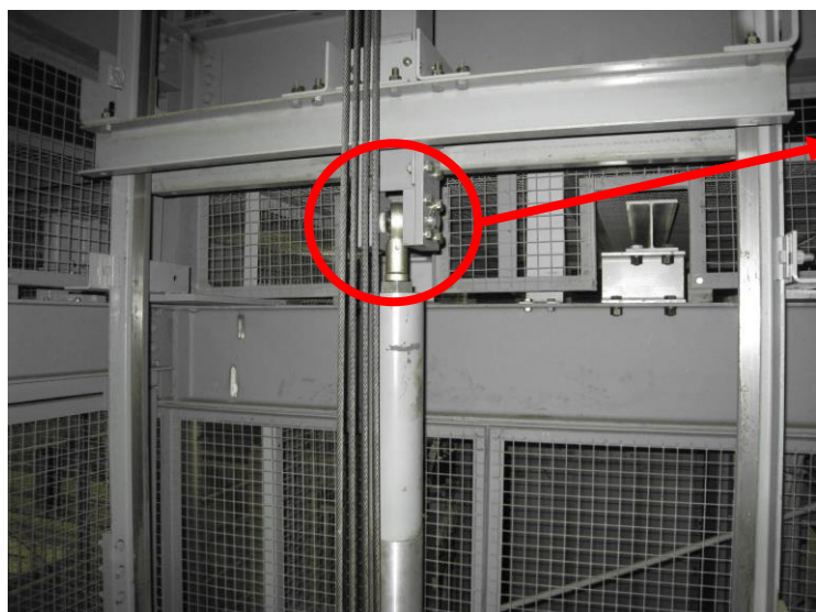
上部二次側固定子取付部（昇降路上部）
